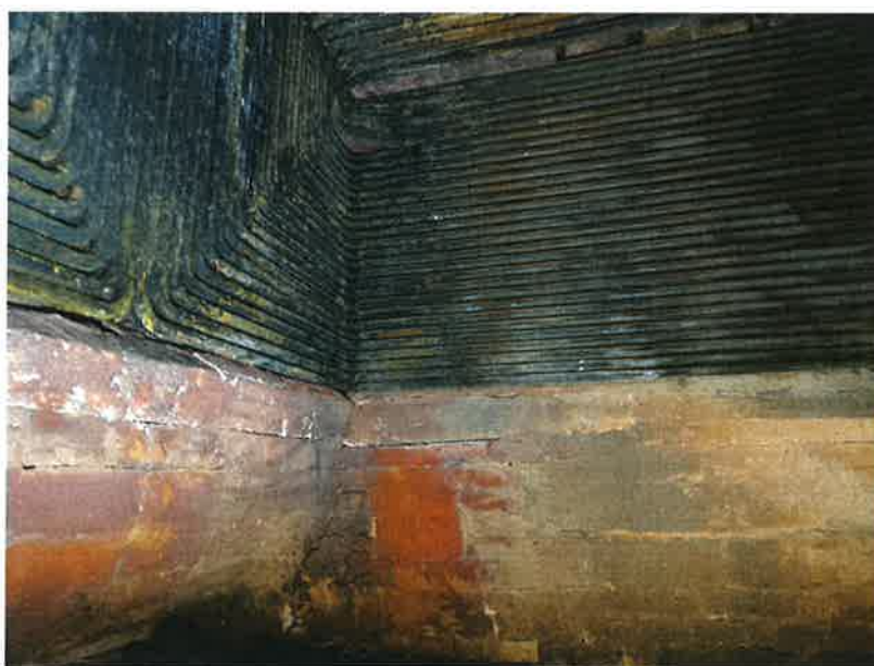
Sklepienie zapłonowe przeznaczone do remontu
